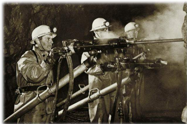
Bildet er fra arbeid med Mont Blanc tunnelen mellom Frankrike og Italia i perioden 1957 – 1965. Utstyret som benyttes til boring er stort sett det samme som i dag.
